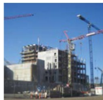
Filborna Power Plant Szwecja 2011-2012 26,2 mln PLN
