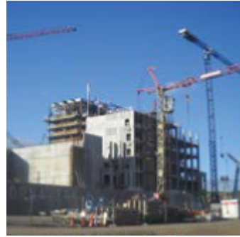
Filborna Power Plant Szwecja 2011-2012 26,2 mln PLN
