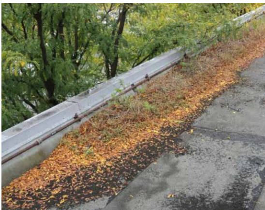
fot. 2. Gromadzące się na krawędzi dachu zanieczyszczenia wpływające na skuteczność systemu odwadniającego powierzchnię dachu [16-S2]
