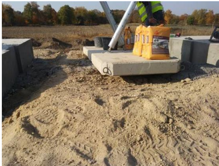
Fot. 7 – Źle przygotowany teren pod rozłożenie płyt.
