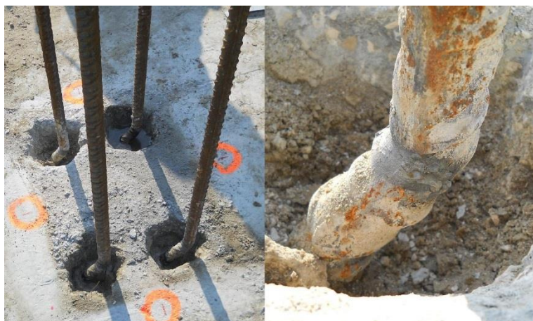
Fot. 22 - Wytyki osadzone w fundamencie pierwotnie w złej lokalizacji, naprawa wykonana nieumiejętnie poprzez nagrzanie i przegięcie. Montaż niemożliwy. Konieczność ponownego wykonania naprawy zgodnie z zaleceniami projektanta.
