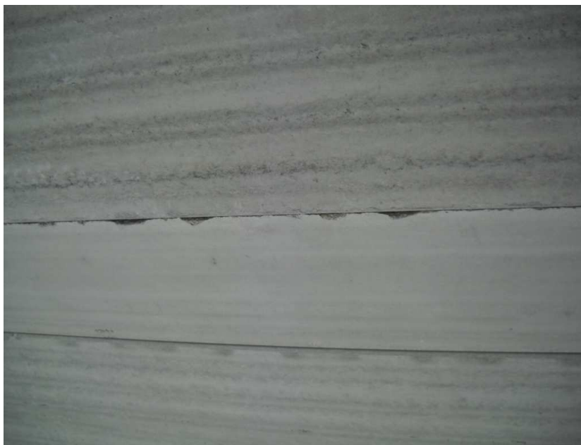
Fot. 2 - Widok stropu wykonanego z płyt HC z widocznymi dopuszczalnymi wyszczerbieniami technologicznymi dolnej krawędzi płyty ciętej zarówno metodą „na mokro” jak i „na sucho”
