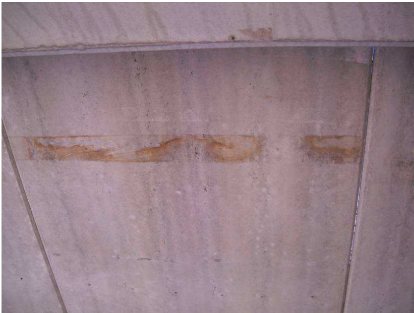
Fot. 16 - Widok odciśniętych podkładek drewnianych na dolnej powierzchni płyt stropowych
