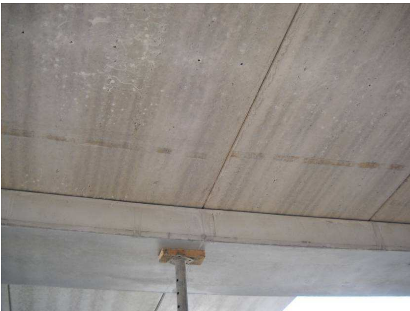
Fot. 15 - Widok odcisniętych podkładek drewnianych na dolnej powierzchni płyt stropowych
