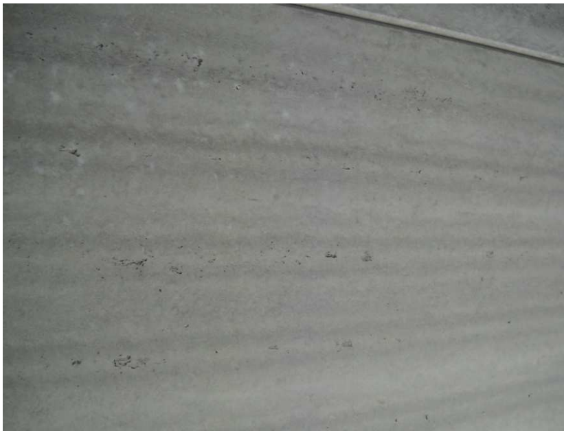
Fot. 17 - Niepodlegające naprawie drobne pory widoczne na dolnej powierzchni płyt stropowych
