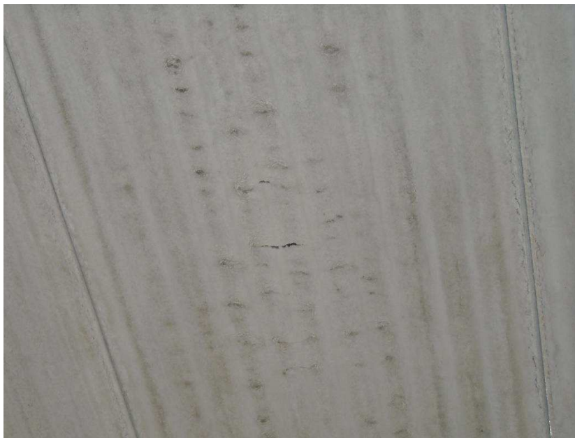
Fot. 18 - Niepodlegające naprawie drobne niedowibrośnięcia betonu na dolnej powierzchni płyt stropowych
