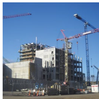
Filborna Power Plant Szwecja 2011-2012 26,2 mln PLN
